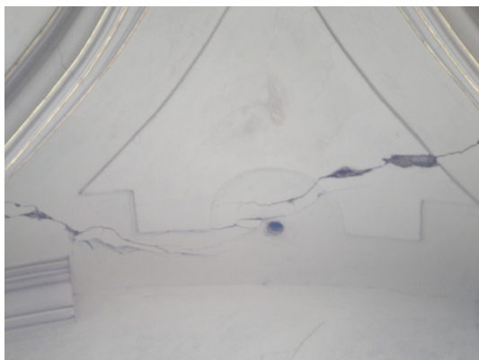
a) Trhlina v patě klenby
