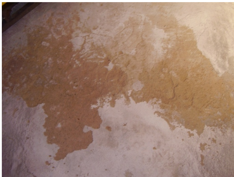
Obr. 8.18: Oddrolování omítek v 1. PP vlivem působící zvýšené vlhkosti – zámek Bílovec
