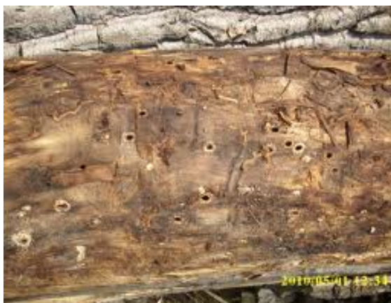
Obr. 8.21: Působení tesaříka krovovéhoho
